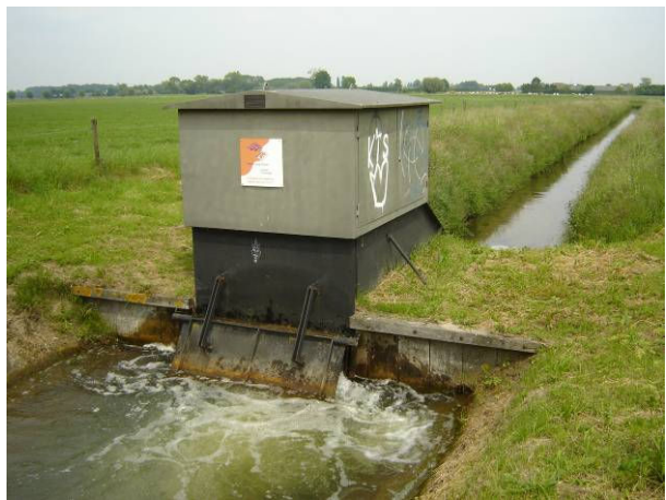
Figuur 2.4: Gemaal Voorderpad.
