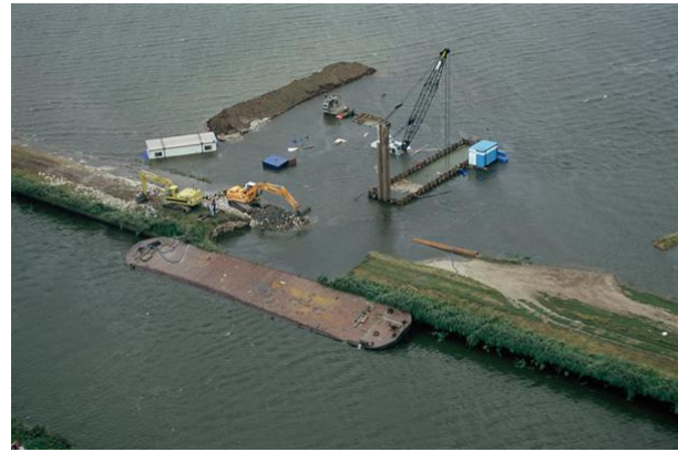
Figuur 39: Dijkdoorbraak na foutieve aanleg gasleiding (Rijkswaterstaat beeldbank)
