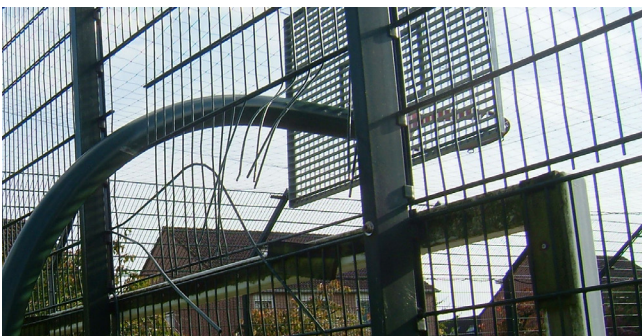
Afbeelding 1-18: Losgescheurde spijlen, Stedon, Duiven
