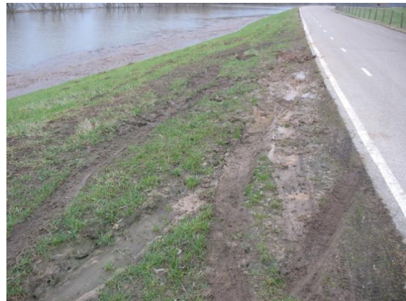
Figuur 9: Schade door ramptoerisme hoofdwaterkering
