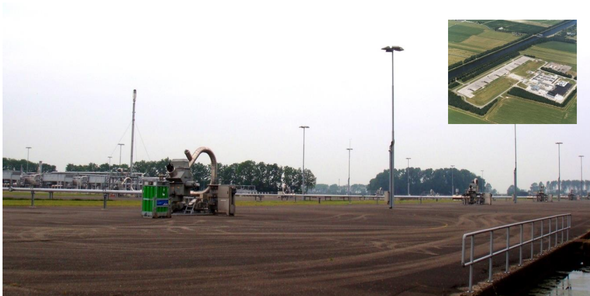
Figuur 59: Grote gaswininstallatie Ten Post zoals gebruikt voor het Groninger gasveld (inzet: vergelijkbare installatie De Pauwen (NAM, 2012))
