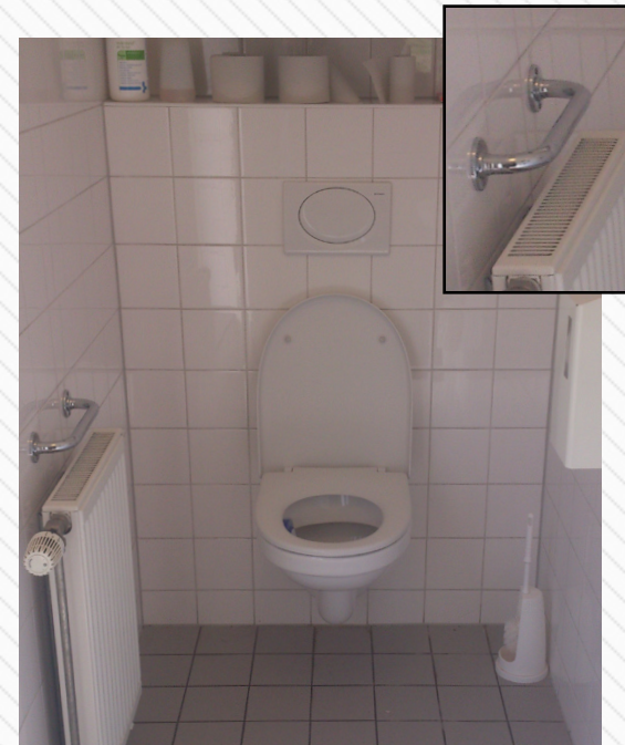
Afbeelding 7.1 - Situatie op het toilet bij zorginstelling: wandbeugel is direct boven de verwarming bevestigd
