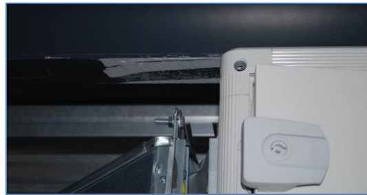
Figuur 8: Beschadigde LBK
