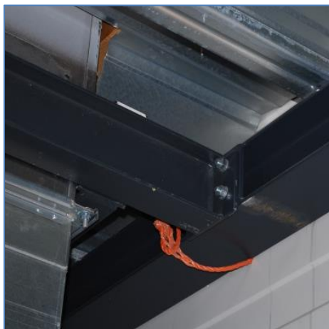
Figuur 7: Verkeerd monteerd strip
