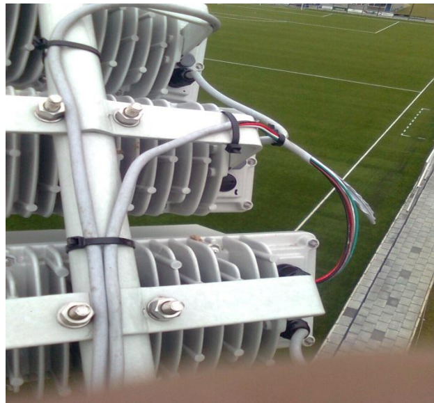
Figuur 4.2 - De kabels zijn blootgesteld aan weersinvloeden door schade aan de beschermende mantel (foto: Vrolijk & Overgaauw)
