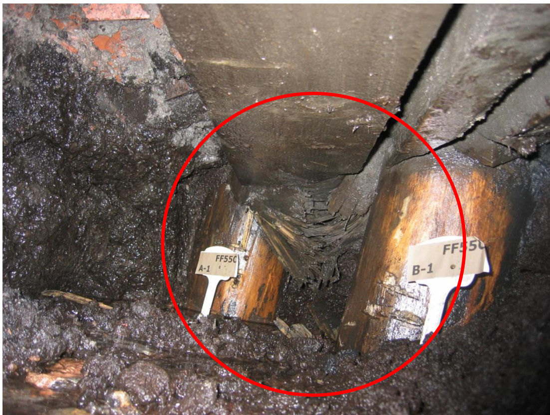
Figuur 2.5: Paalrot in funderingen als gevolg van een te lage grondwaterstand (Wareco, z.d.)
