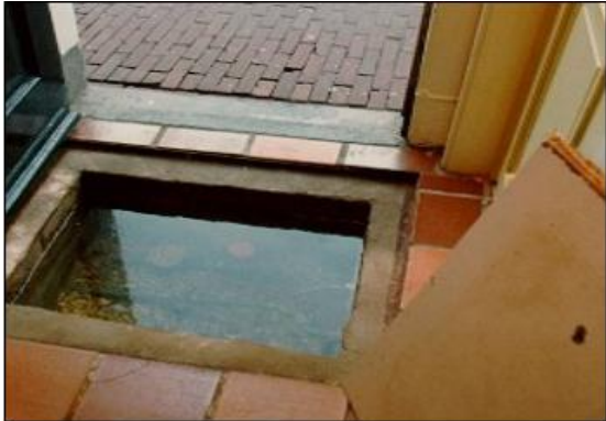
Figuur 2.3: Grondwateroverlast in de kruipruimte door een te hoge grondwaterstand (Wareco, z.d.)
