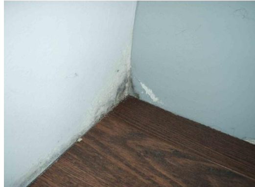
Figuur 2.4: Vochoptrekking in de muren van een woning door een te hoge grondwaterstand (Wareco, z.d.)
