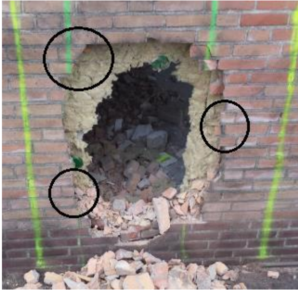
Figuur 16: bakstenen bezwaken op afschuiving.
