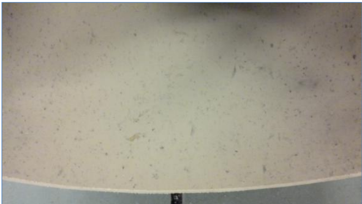
Figuur 40: Fragmentatieschade tunnelbuis.
