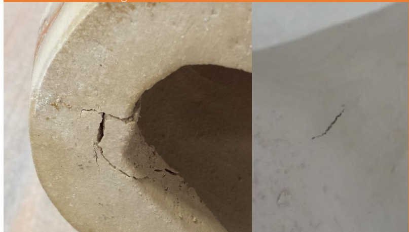
Figuur 73: Scheuren aan de binnenkant
