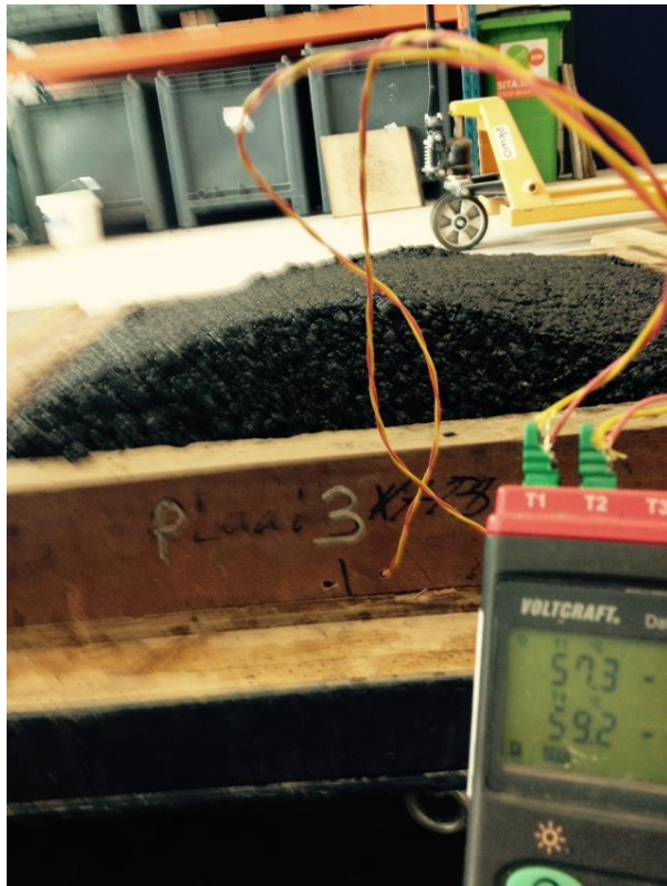
Slechte verdichting van plaat 5 wegens laag temperatuur
