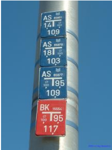
Figuur 17 Locatiebordjes brandkranen en waterputten (Wikipedia, 2015)
