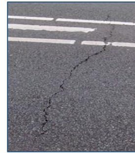
Figuur 25: Vorstschade aan het wegdek
