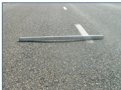
Figuur 28: Voorbeeld spoorvorming.
