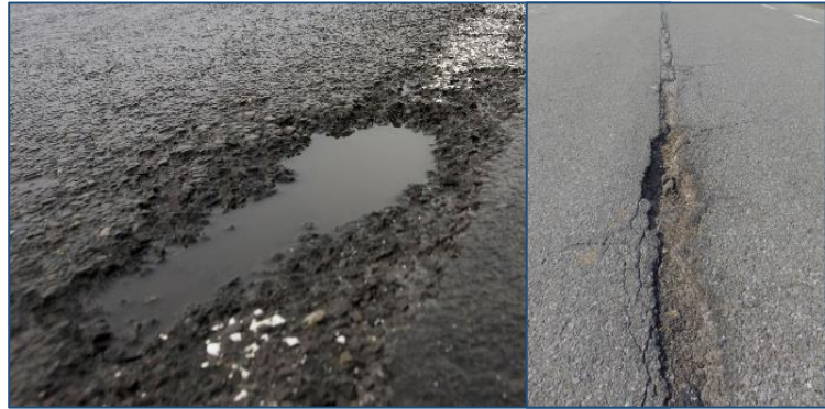
Figuur 1: Voorbeelden vorstschade aan het wegdek
