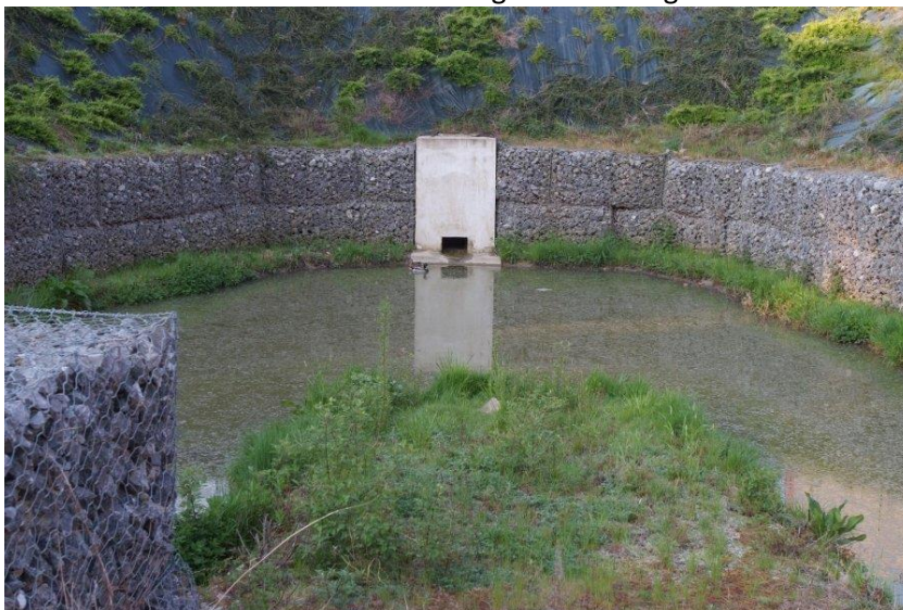
Figuur 35, Bufferbekken (Distripont, 2015)
