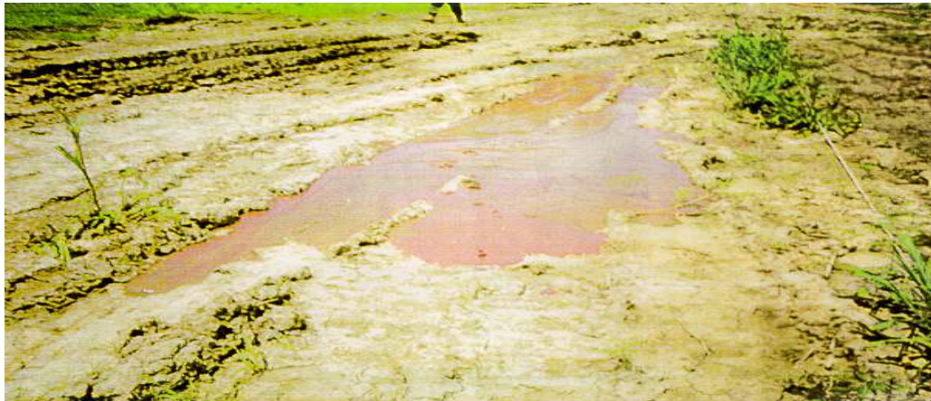
Figuur 5.5: Blow-out HDD
