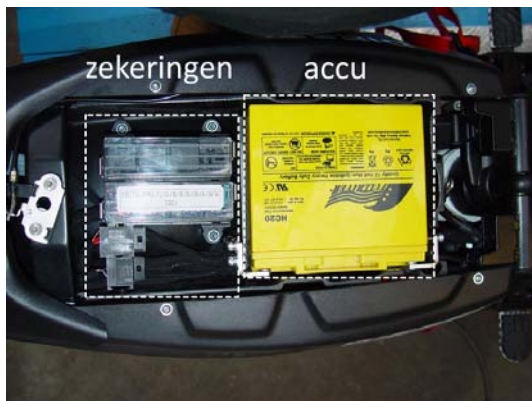
Figuur 11 - Foto huidige situatie zekeringen en accu
