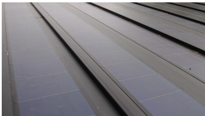
Afbeelding 3.2-c PV panelen op Sandwichpanelen (Triple Solar (3), 2011)
