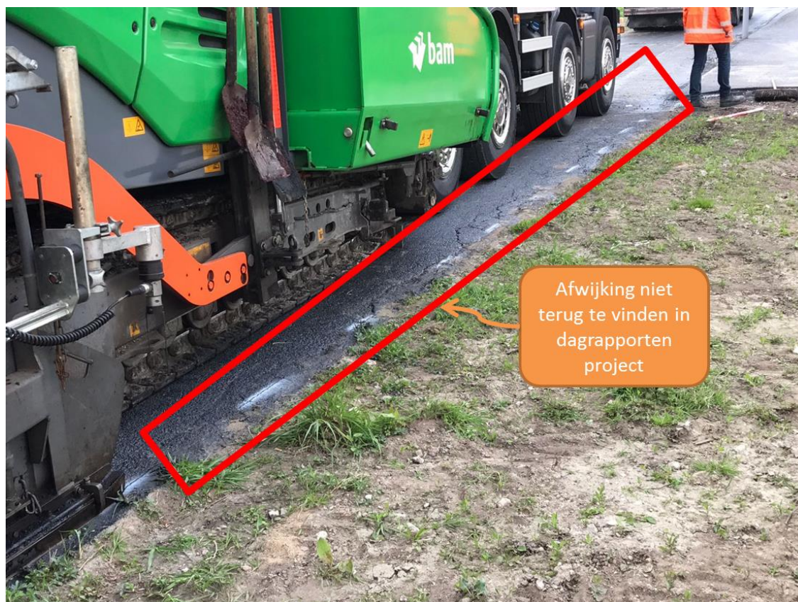
Figuur 7 Afwijking voorkomend op projectlocatie, echter niet geregistreerd in dagrapport.
