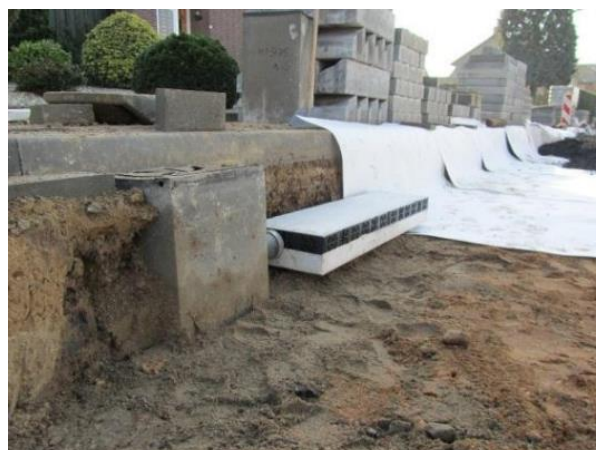
Figuur 35 – Kolk naar waterbergend pakket met bezinkunit en olieverwerkend filterdoek (Aquaflow, 2017a)
