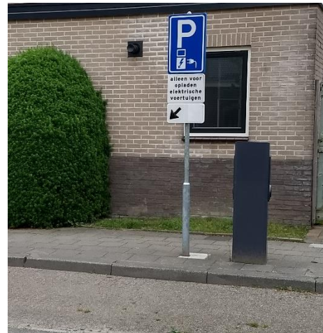
Figuur B12 Laadpaal met één van de twee laadpunten in gebruik
