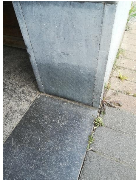
Figuur C-19: Waterlijn ingang Nieuwstraat 32
