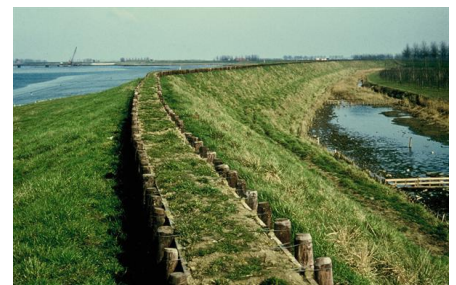
Figuur 38 Kistdam in een dijk in Zeeland met een uitstekende kop Bron: (De Beeldbank, 1986)
