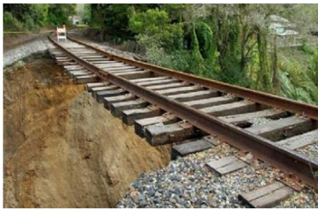
Figuur 4: Wegspoeling van spoorbedding (Dindar et al, 2017)
