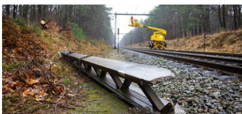
Figuur 12: Kapotte bovenleidingsportaal bij Apeldoorn na storm Eunice (ProRail, 2022)
