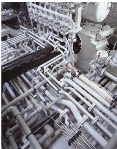
Figuur 7: Leidingwerk inbouw machinekamer
